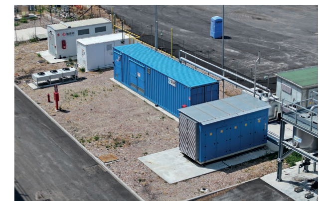
Il sistema di upgrading del biometano presso l'impianto di Copparo, Ferrara
