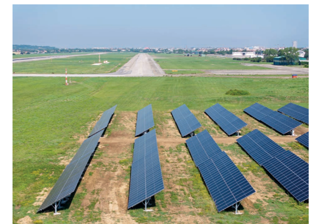
L'impianto fotovoltaico presso l'Aeroporto Internazionale "Federico Fellini", Rimini
