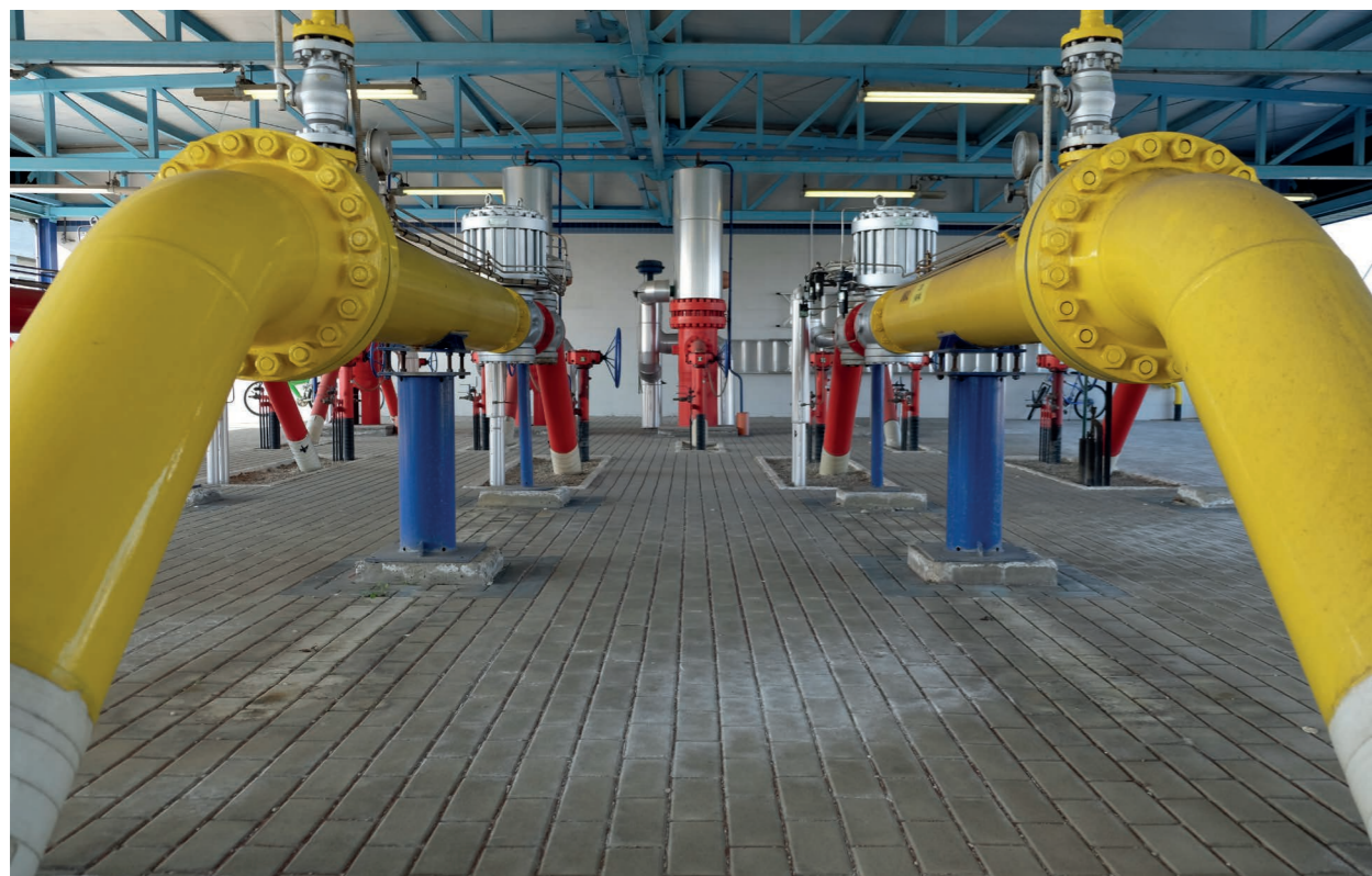
La cabina di primo salto della rete SNAM presso ADRIGAS
